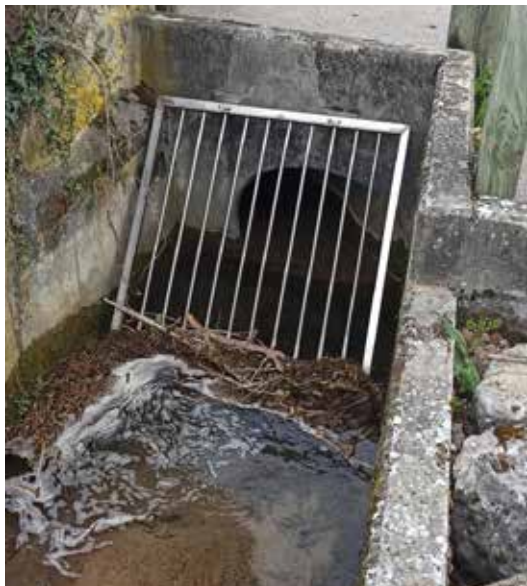
Rue de l'église, piège à flottants
